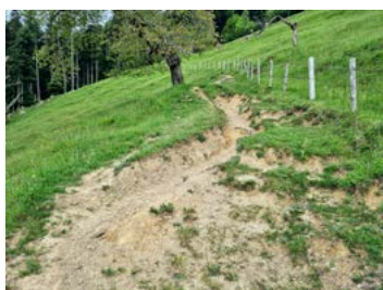
Fig. 4 Esempio di tracciato instabile a causa dell'erosione
