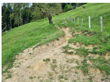
Fig. 4 Exemple de tracé instable en raison de l'érosion
